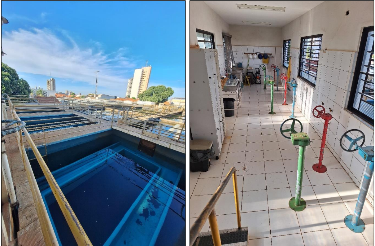
Figura 127 - Etapa de Filtração no Tratamento de Água
