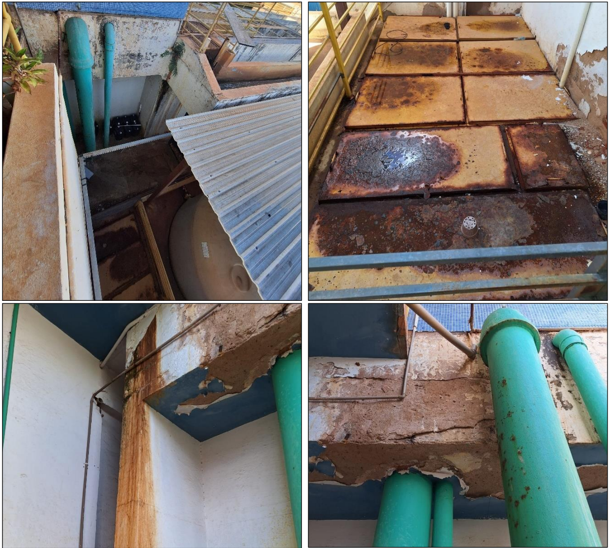
Figura 79: Área Externa Inferior ETA
