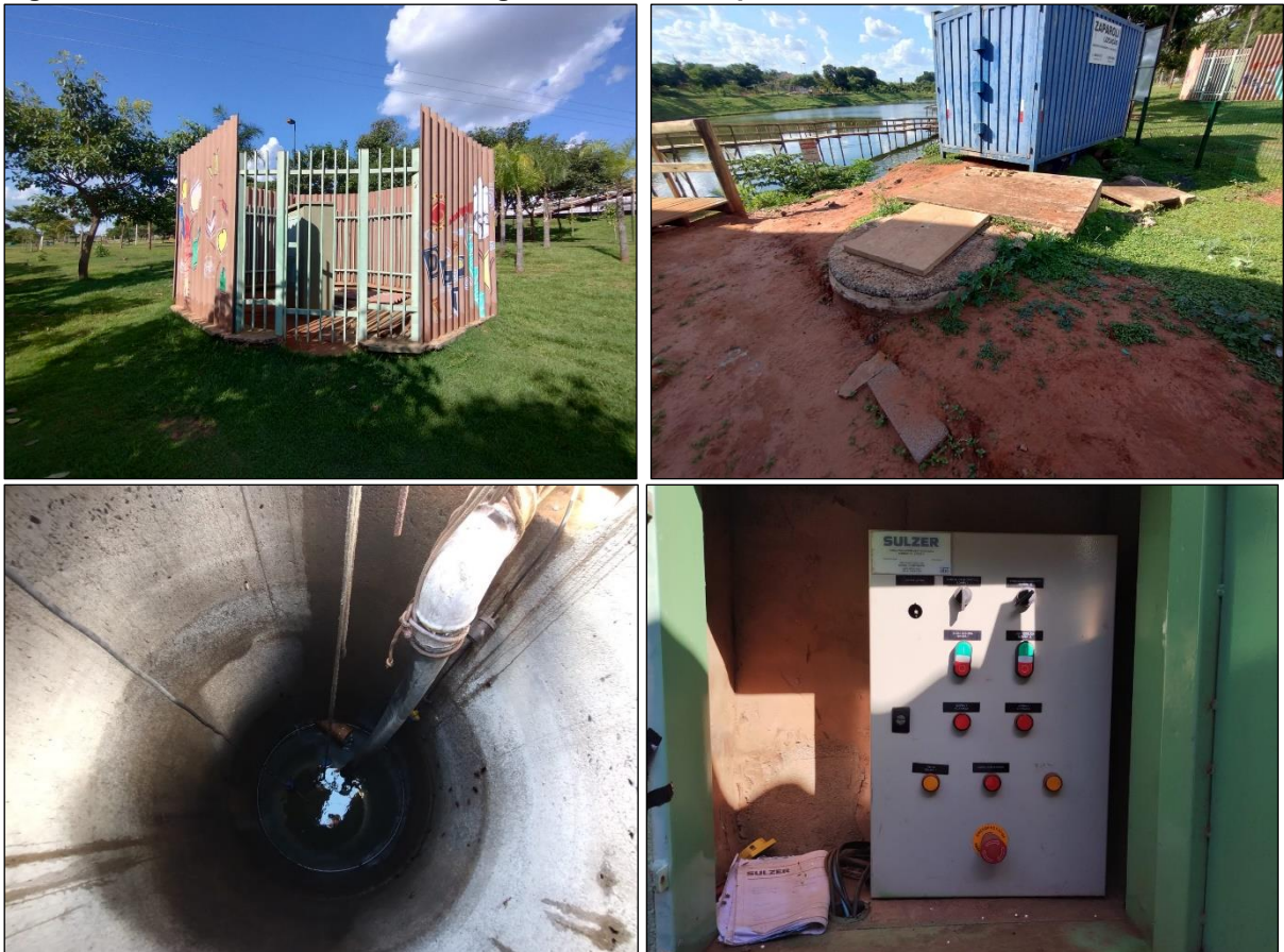
Figura 166: Estação Elevatória de Esgoto Sistema Parque da Cultura
