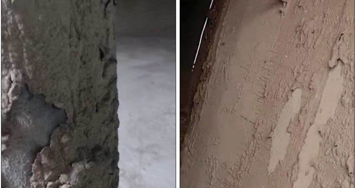
Figura 108: Impermeabilização do Reservatório Semienterrado Danificada
