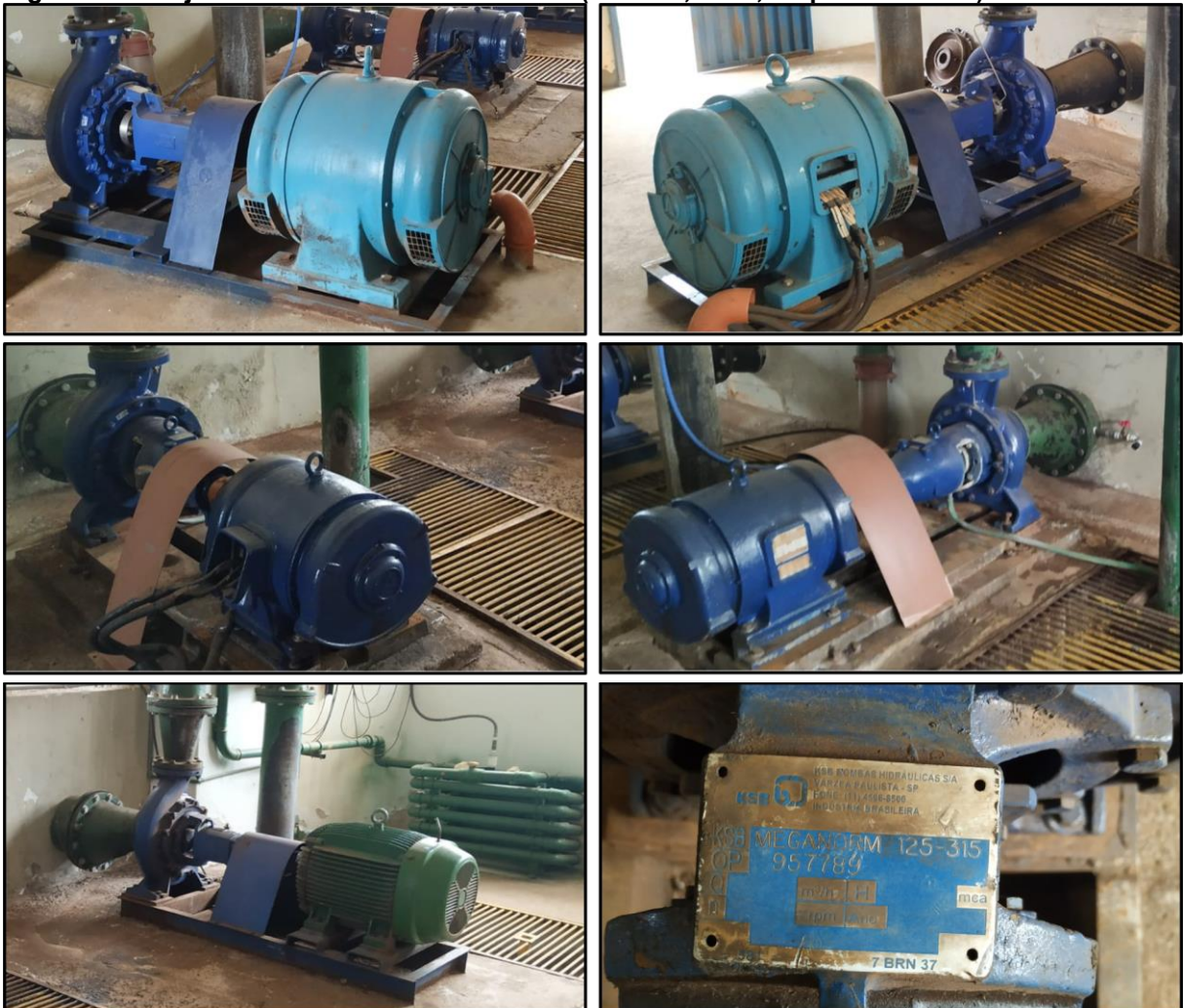
Figura 91: Conjuntos Motobomba Sistema Sul (C.M.B 1, 2 e 3, respectivamente)
