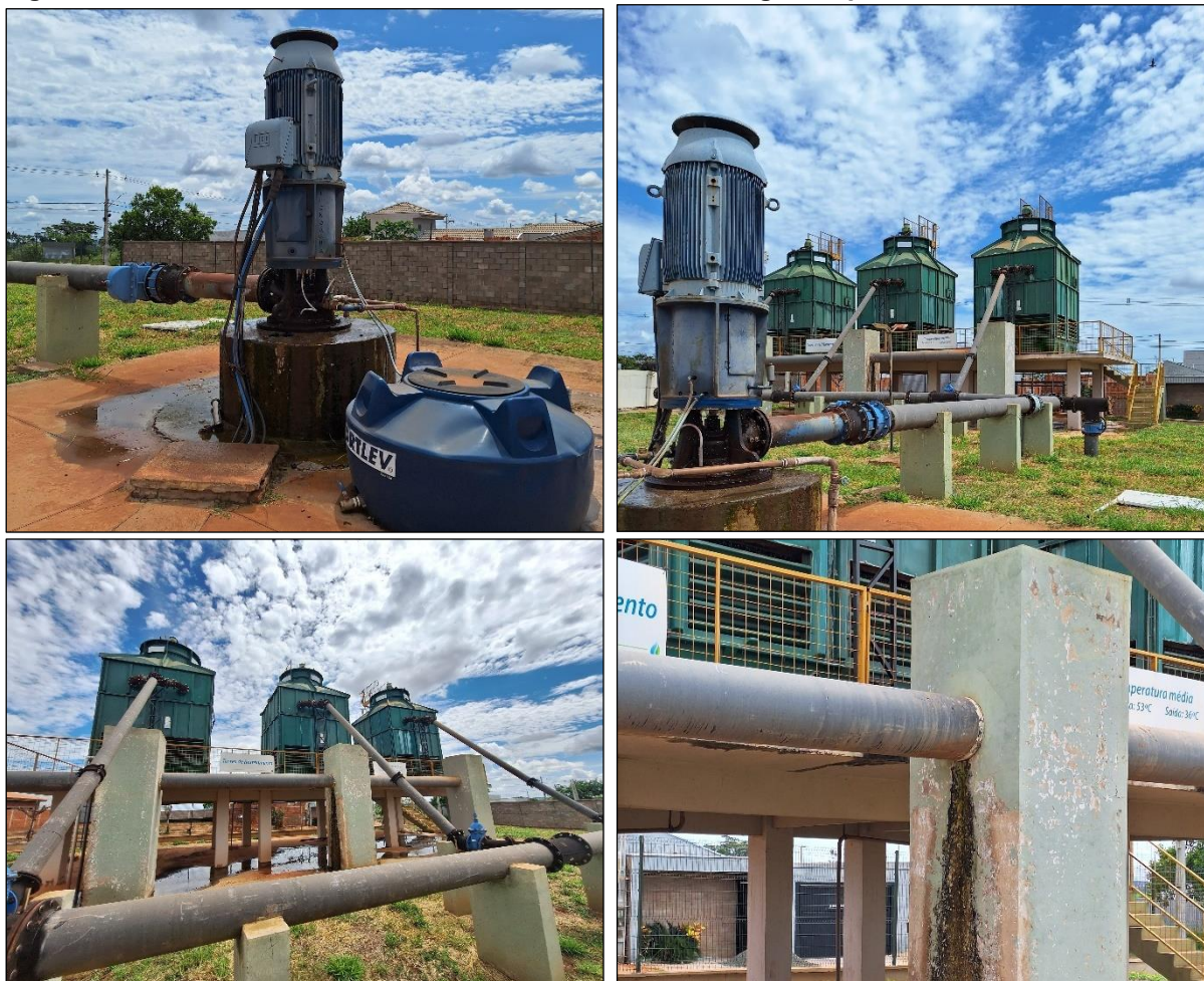
Figura 110: Poço Profundo e Sistema de Resfriamento de Água Captada
