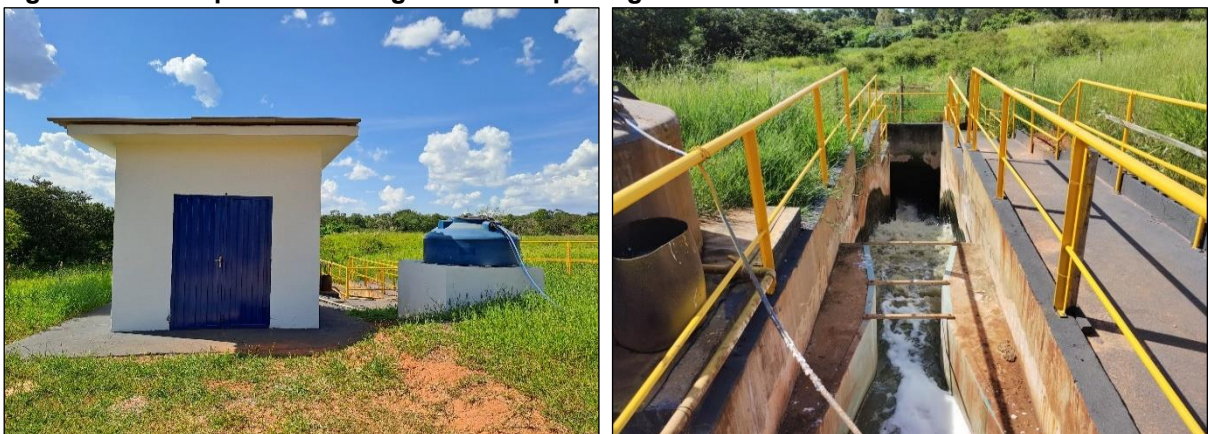
Figura 176: Dissipador de energia ETE Votuporanga
