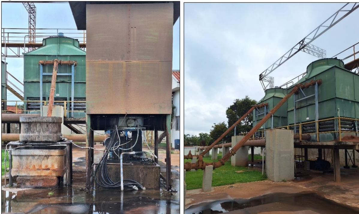
Figura 87: Poço Profundo Sistema Norte
