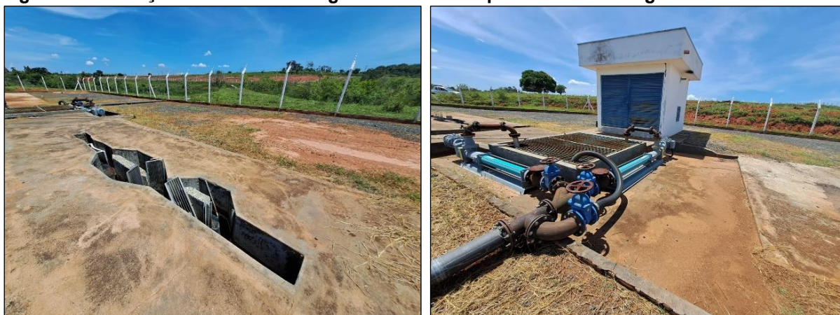
Figura 165: Estação Elevatória de Esgoto Sistema Parque Residencial Figueira
