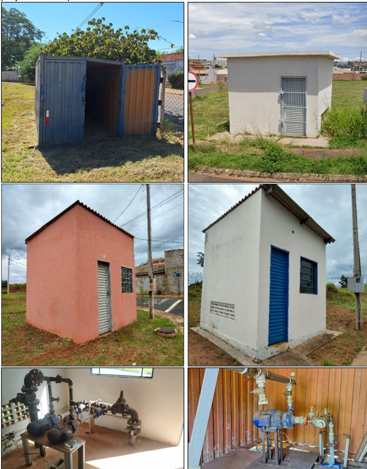
Figura 139 - Sistemas de recalque Ecotudo Sul, Cidade Jardim, Noroeste e Monte Verde (respectivamente)
