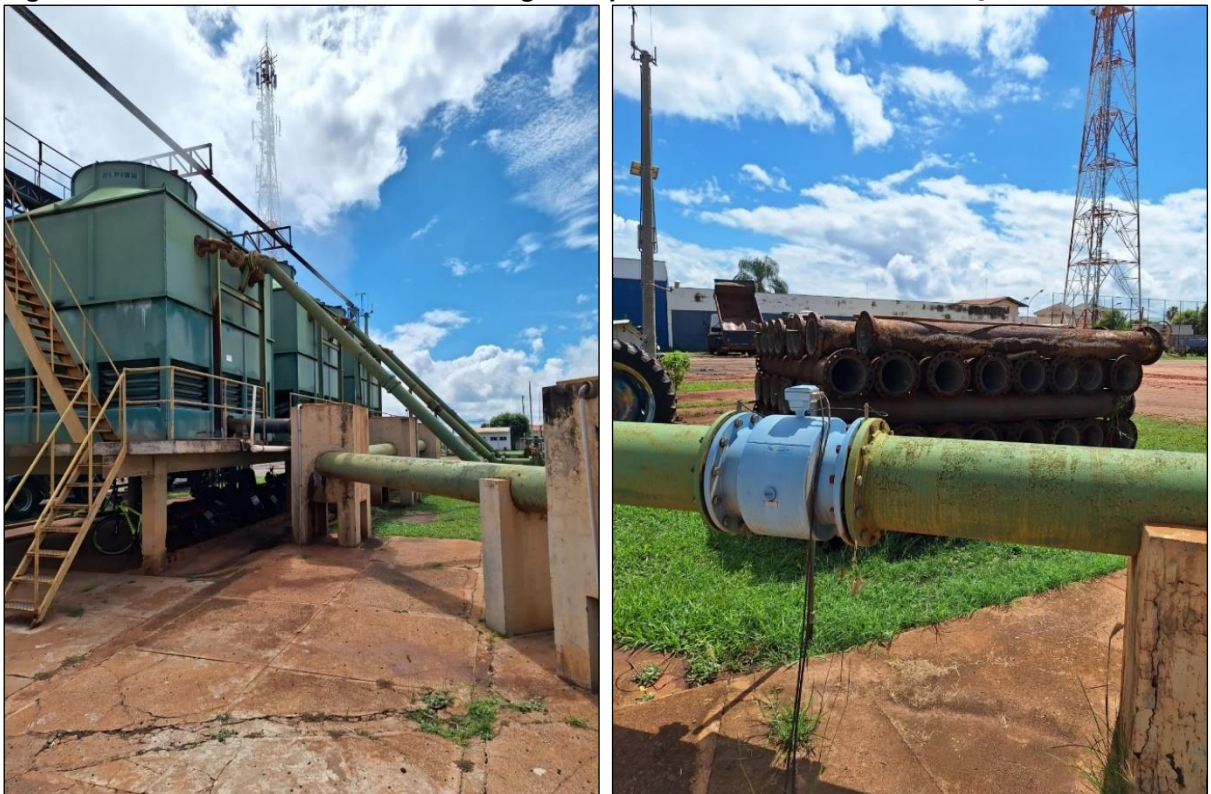
Figura 99: Sistema de Resfriamento de Água Captada e Macromedidor do Poço
