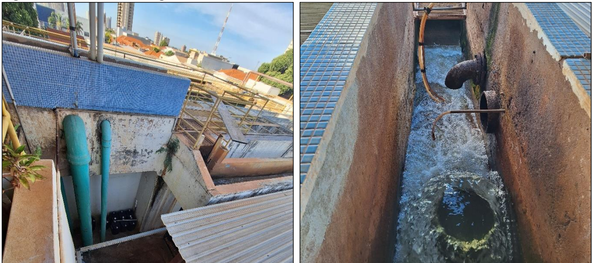
Figura 123 - Entrada de Água Bruta e Pré-Cloração
