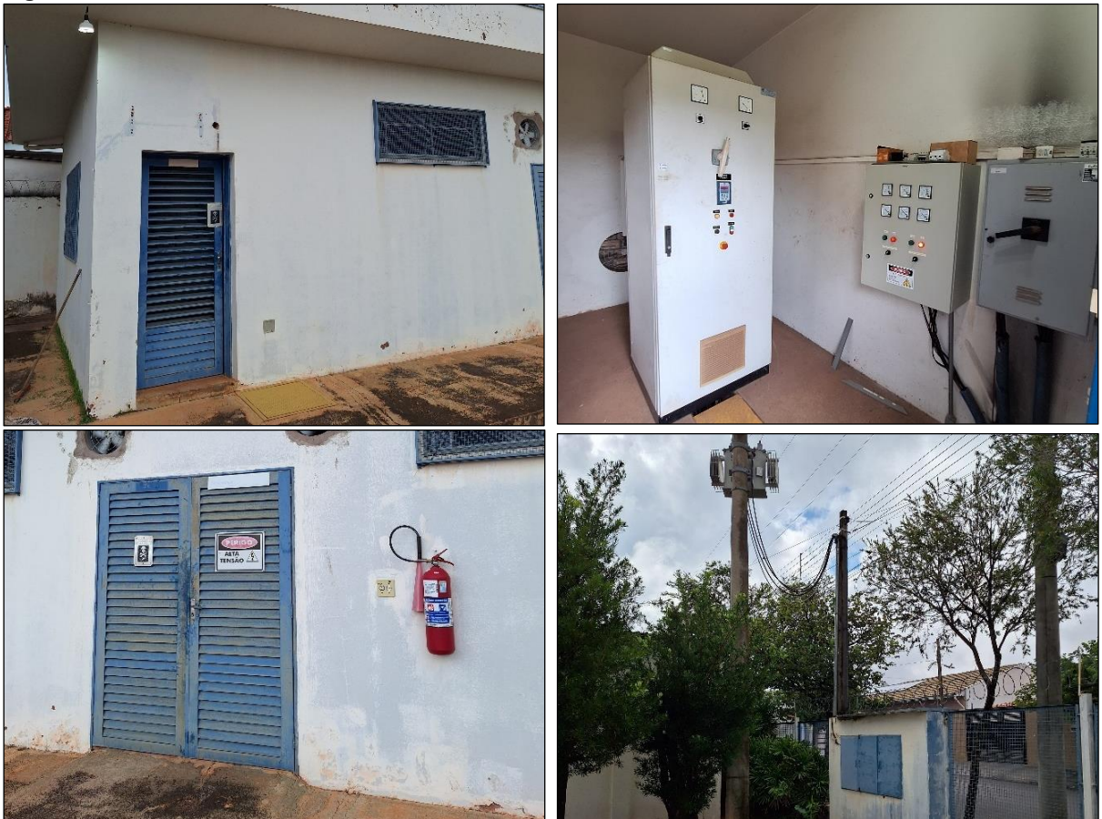
Figura 86: Casa de Força Sistema Norte
