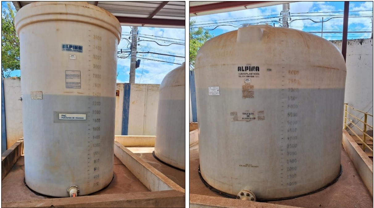
Figura 124 - Reservatórios de Policloreto de Alumínio e Sulfato de Alumínio
