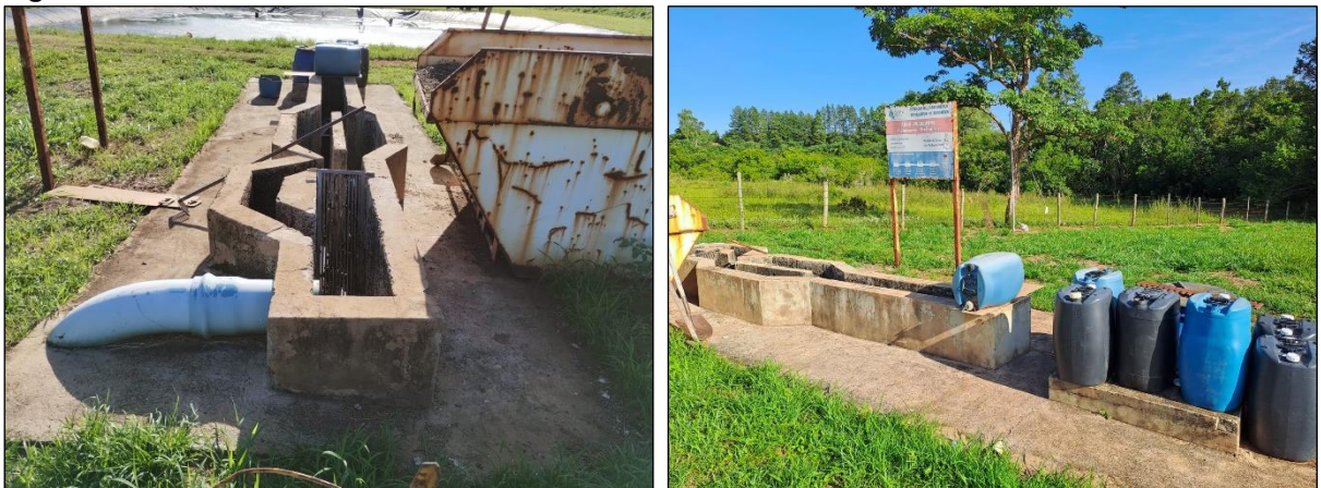
Figura 179: Sistema Preliminar da ETE Simonsen
