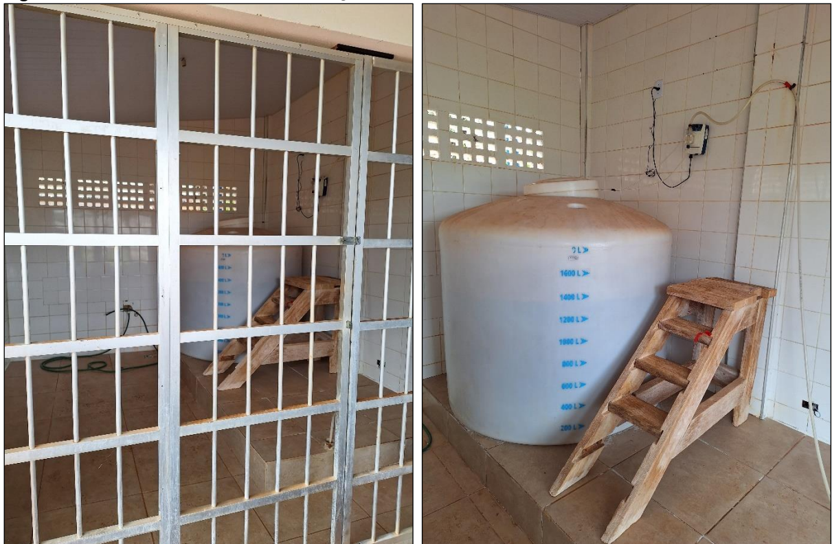
Figura 132 - Sistema de Tratamento Poço Norte
