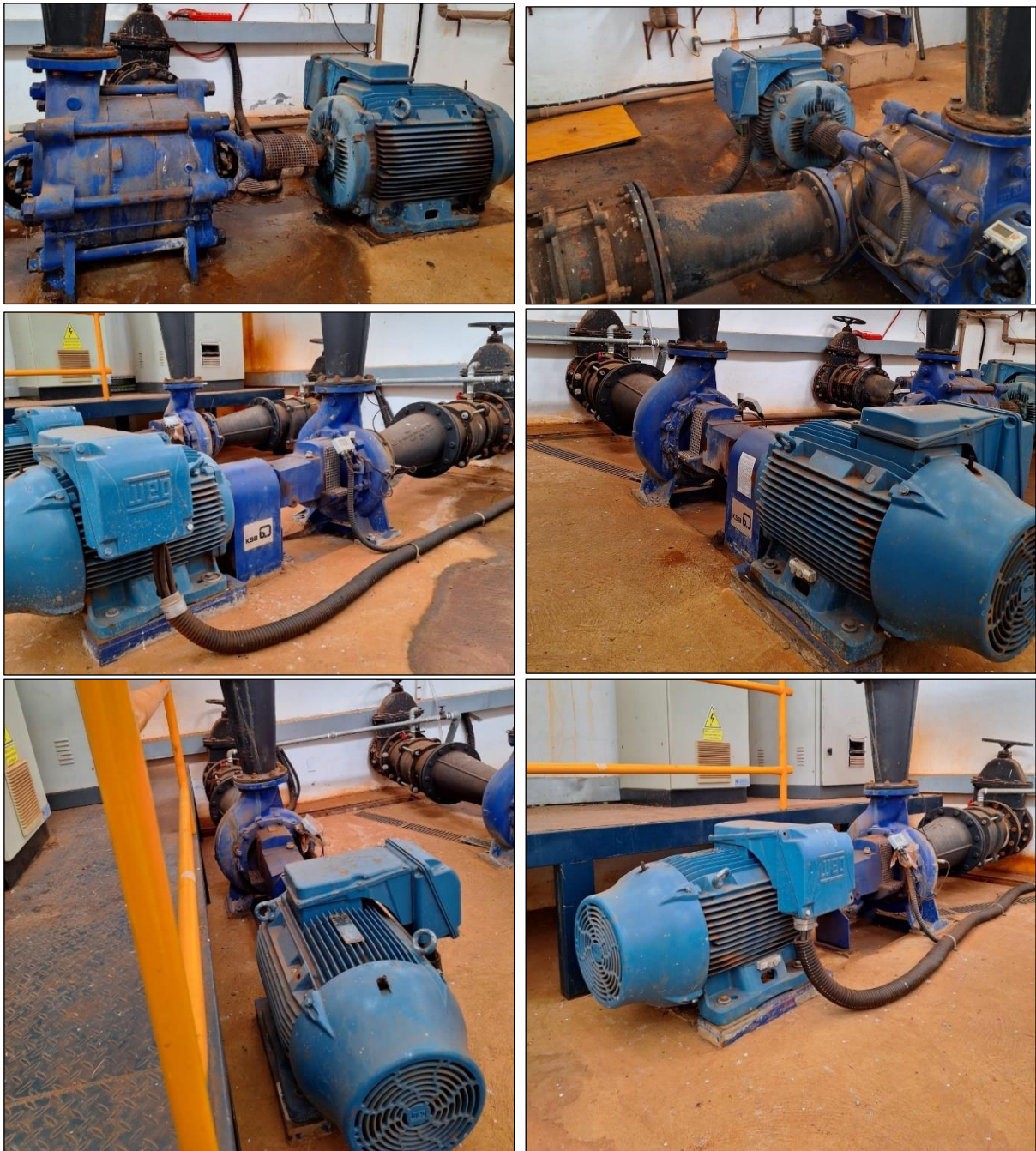
Figura 101: Conjuntos Motobomba Sistema Sudeste (C.M.B 1, 2 e 3, respectivamente)
