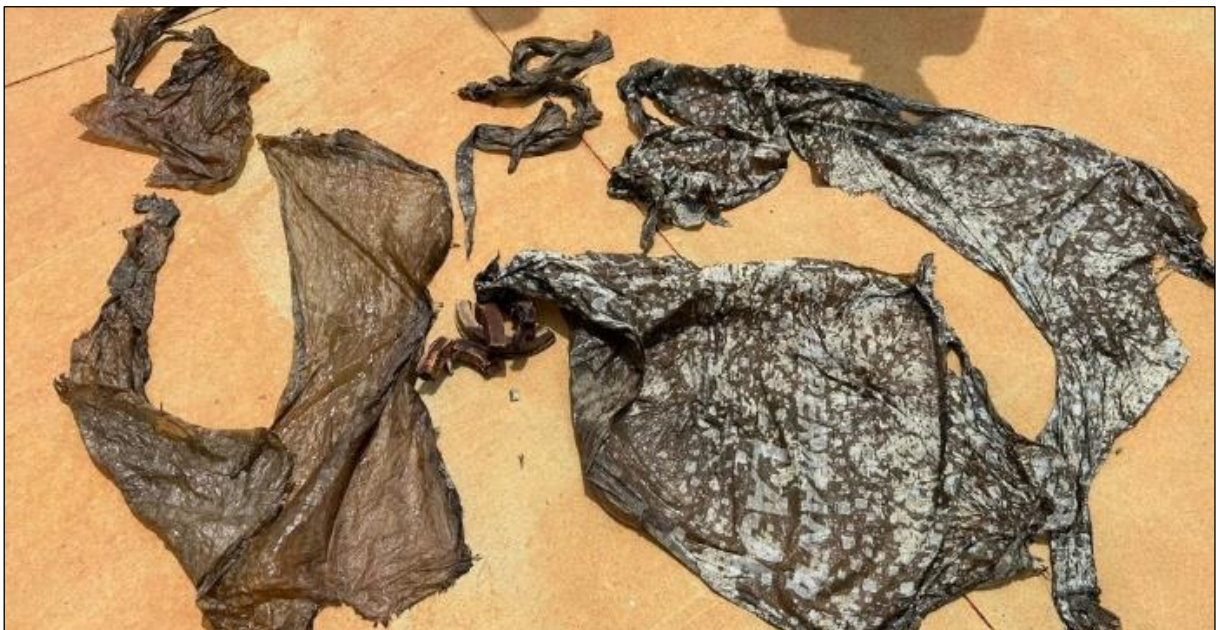
Figura 109: Descolamento do Filme de Polietileno da Impermeabilização do Reservatório Elevado
