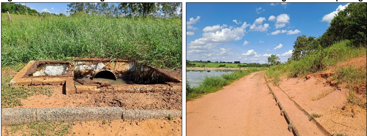
Figura 174: Corrosão das grades e assoreamento das canaletas de drenagem ETE Votuporanga
