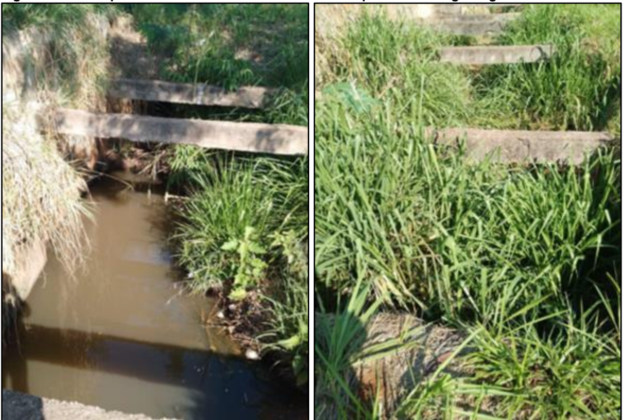
Figura 280: Dissipadores na Rua Dr. Antonio Corrêa esquina com Jorge Augusto R. Fabiano
