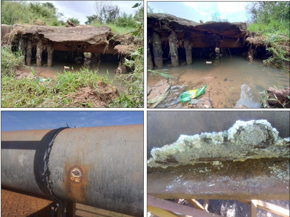
Figura 161: Estado de conservação de algumas travessias
