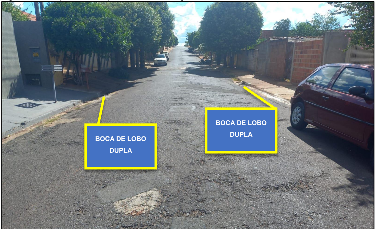
Figura 253: Dispositivos superficiais de drenagem na Área 12
