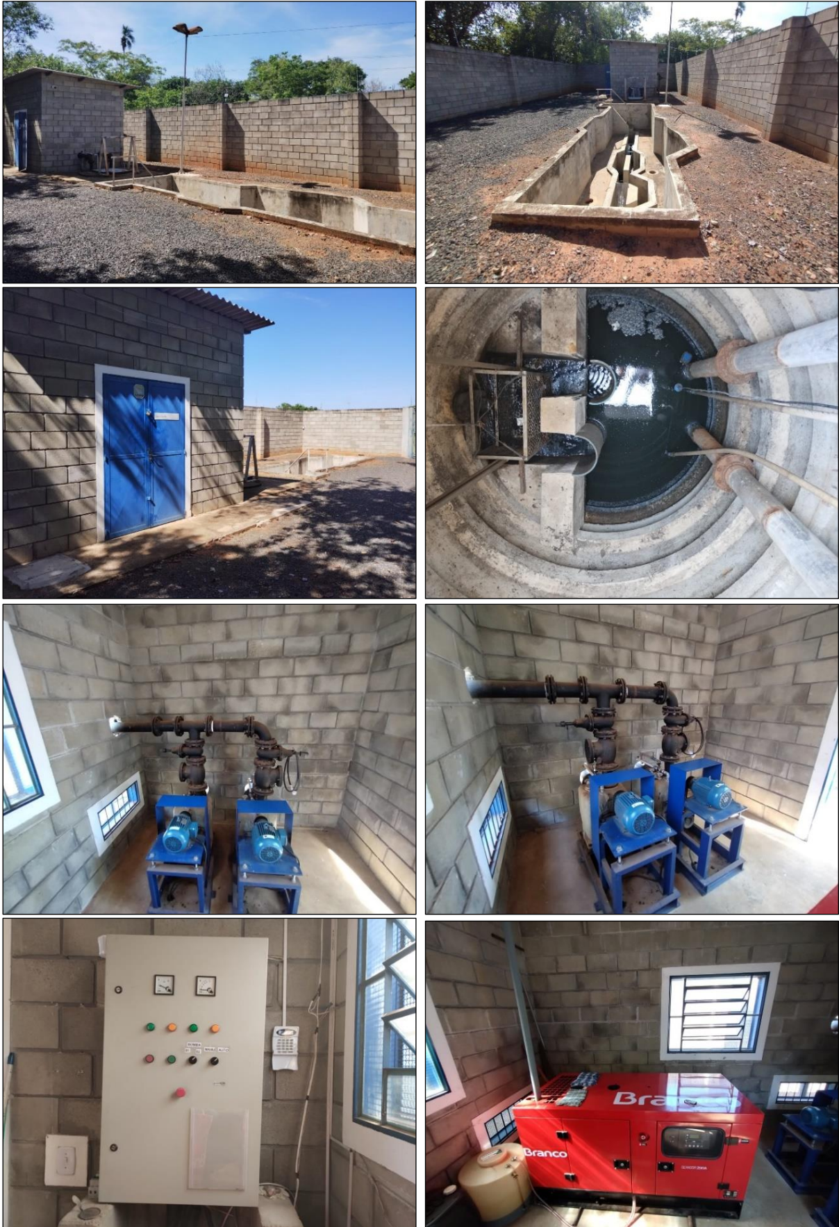
Figura 163: Estação Elevatória de Esgoto Sistema Cidade Jardim II
