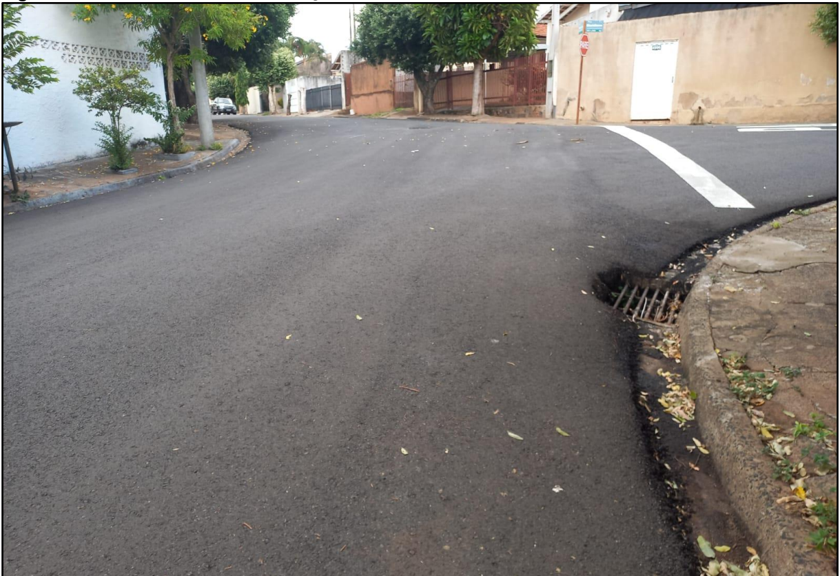
Figura 250: Cruzamento da Rua Praça Meridiano com a Hermínio Ferrato
