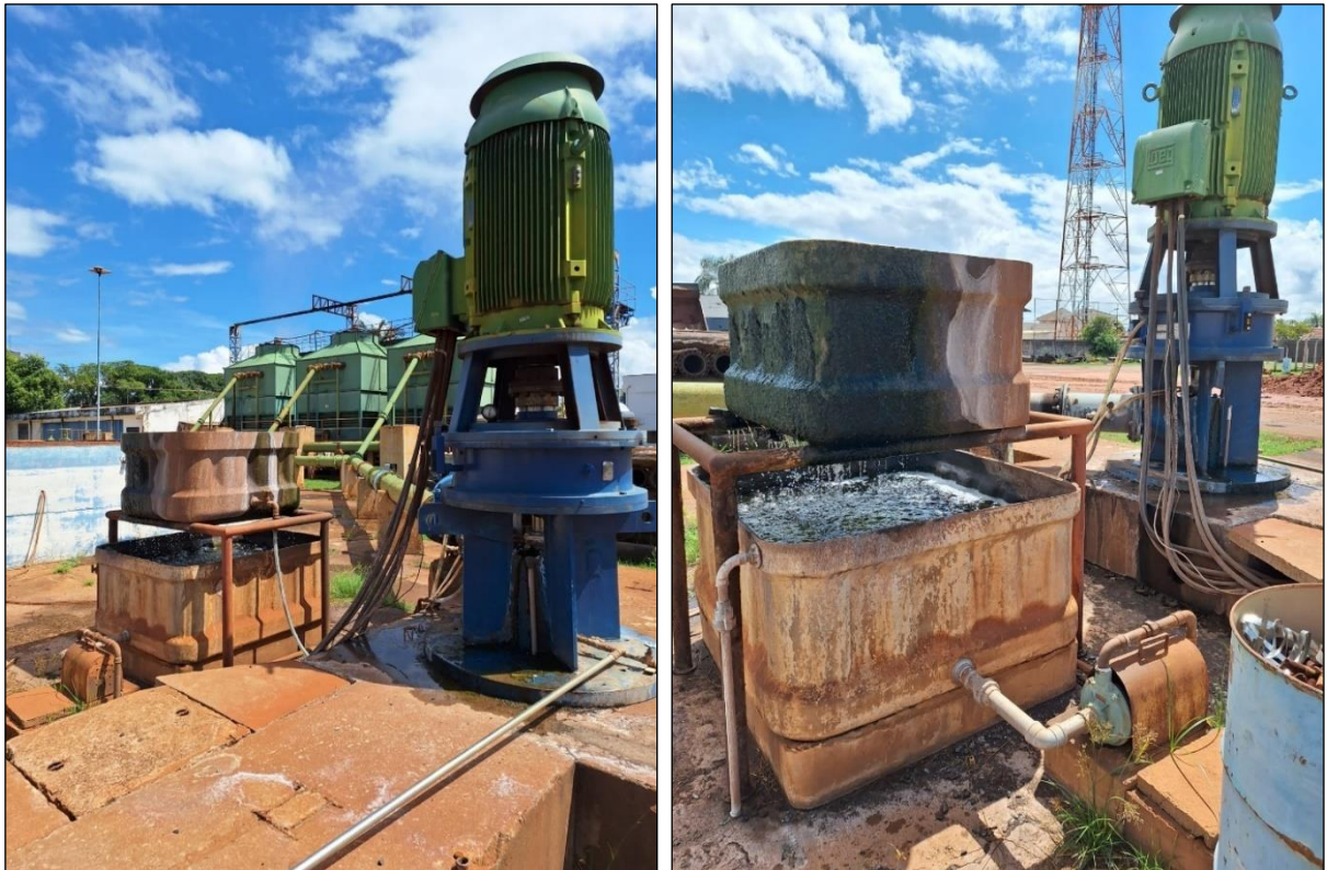
Figura 98: Poço Profundo Sistema Sul
