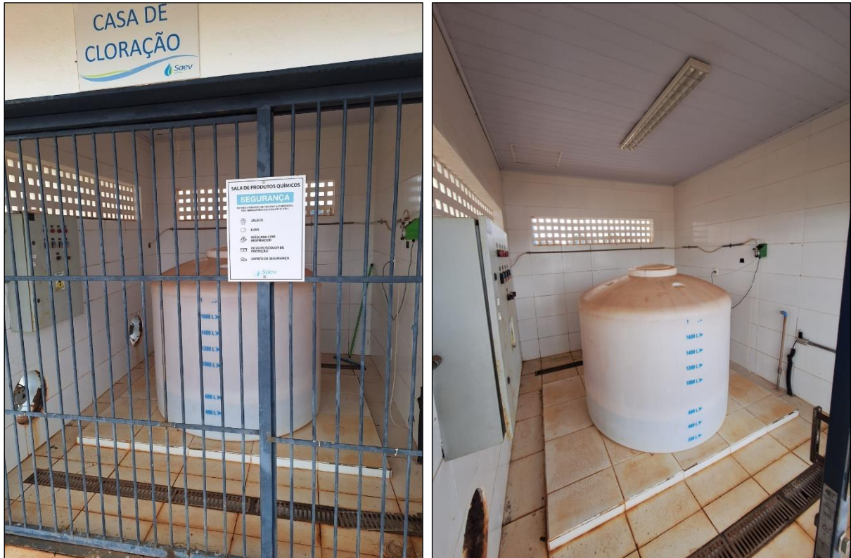
Figura 133 - Sistema de Tratamento Poço Sudeste
