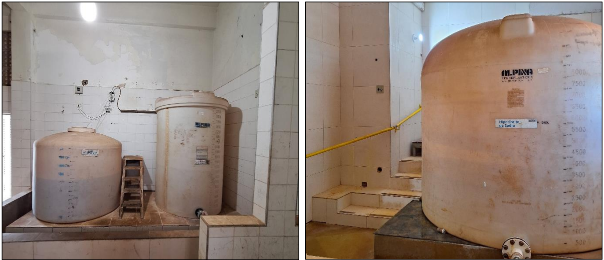
Figura 128 - Reservatórios de Hipoclorito de Sódio 12% e Ácido Fluossilícico
