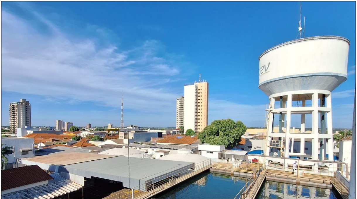
Figura 130 - Reservatórios Semienterrados e Elevado Sistema Central
