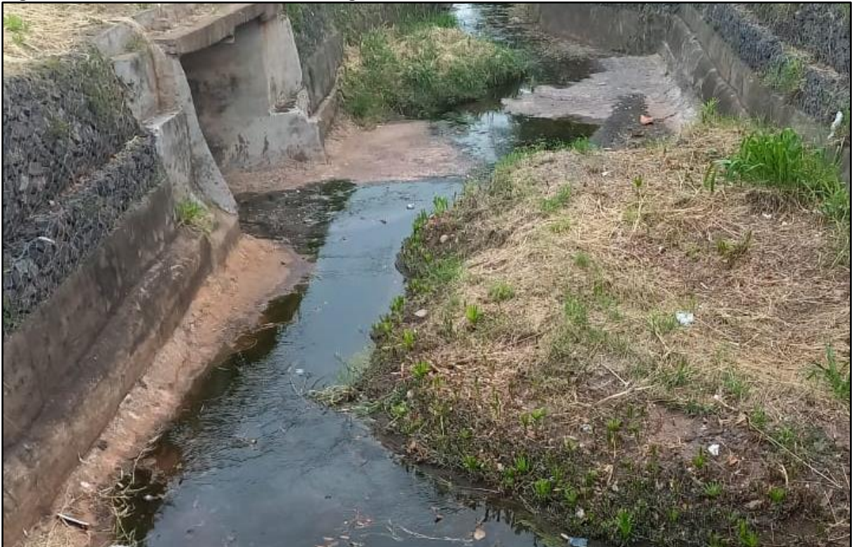
Figura 290: Trecho canalizado do córrego Boa Vista – Rua Dona Maria de Freitas Leite
