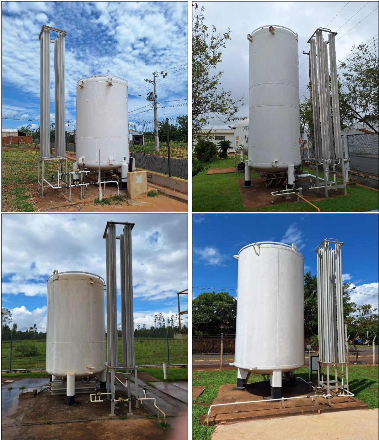
Figura 135 - Sistema de Tratamento com CO2 Presentes nos Poços Oeste, Norte, Sudeste e Sul Respectivamente
