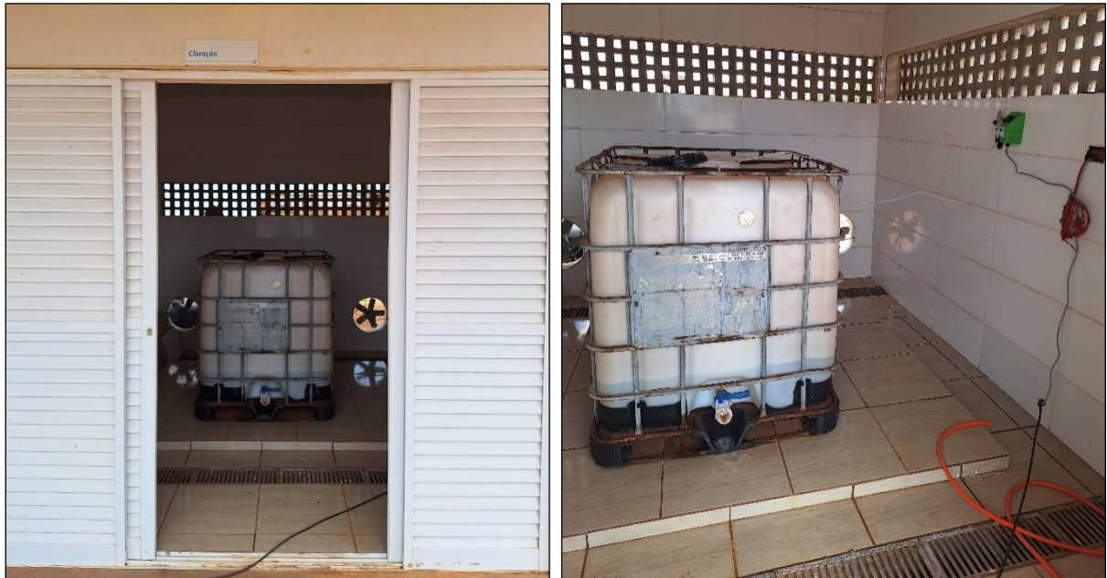
Figura 131 - Sistema de Tratamento Poço Oeste
