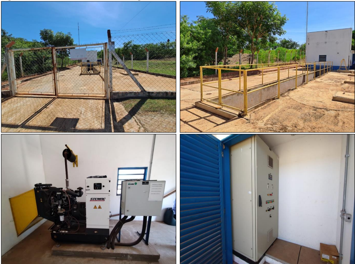
Figura 164: Estação Elevatória de Esgoto Sistema Anna Munhoz Alvares
