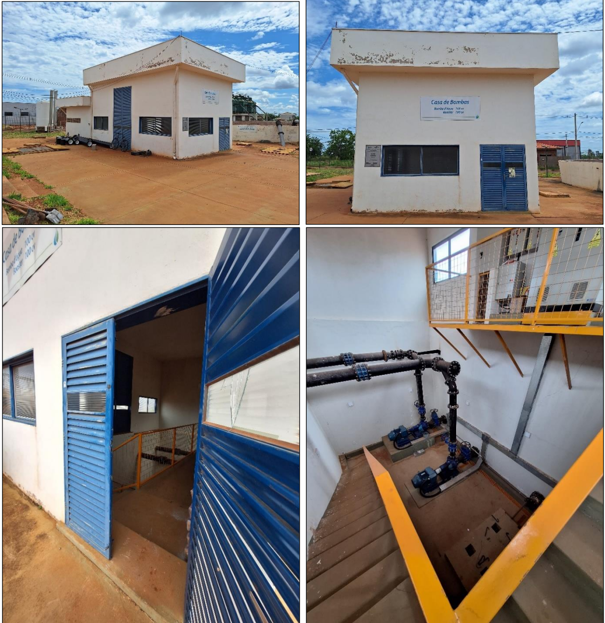
Figura 111 - Casa de Bombas Sistema Oeste
