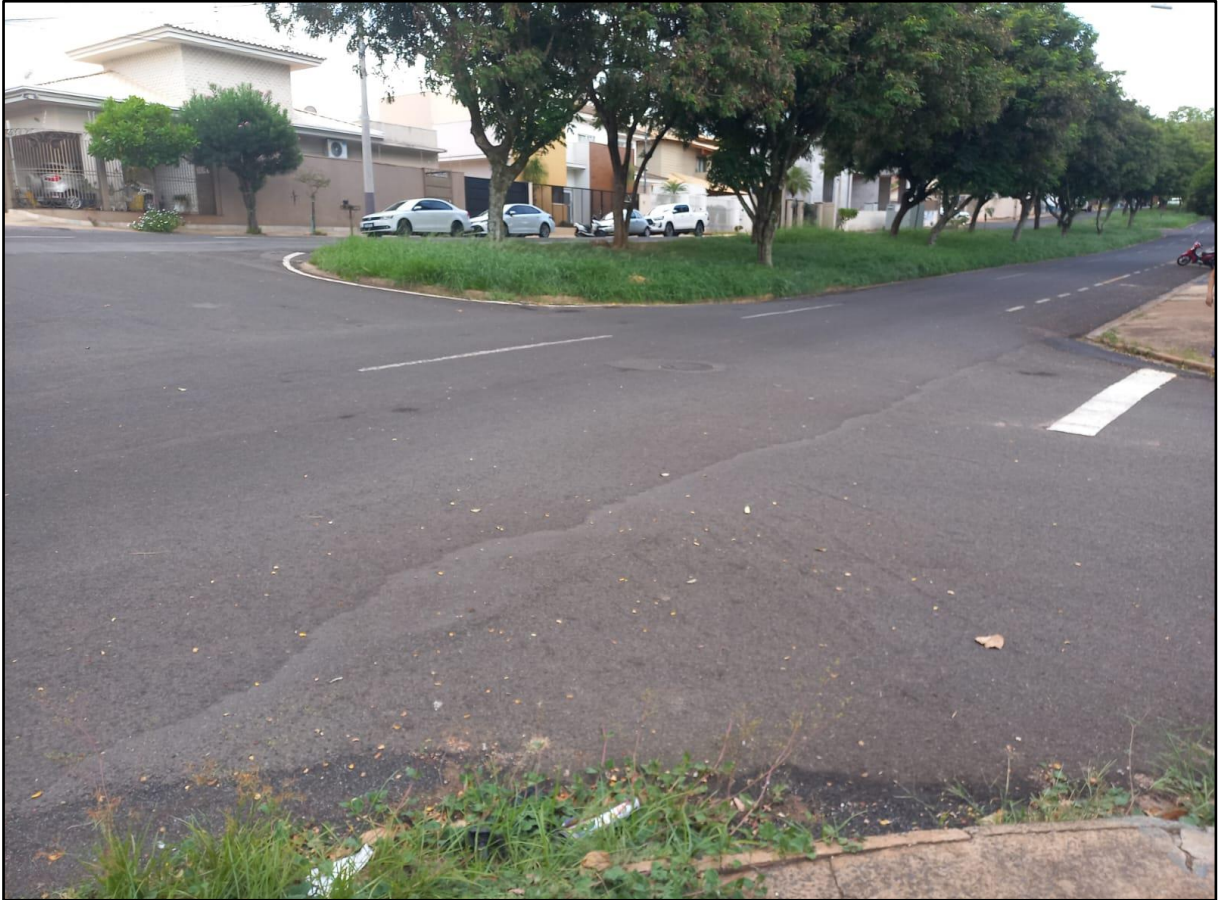
Figura 260: Declividade acentuada no cruzamento da Av. Tarjino F. Granja com a Rua Argentina
