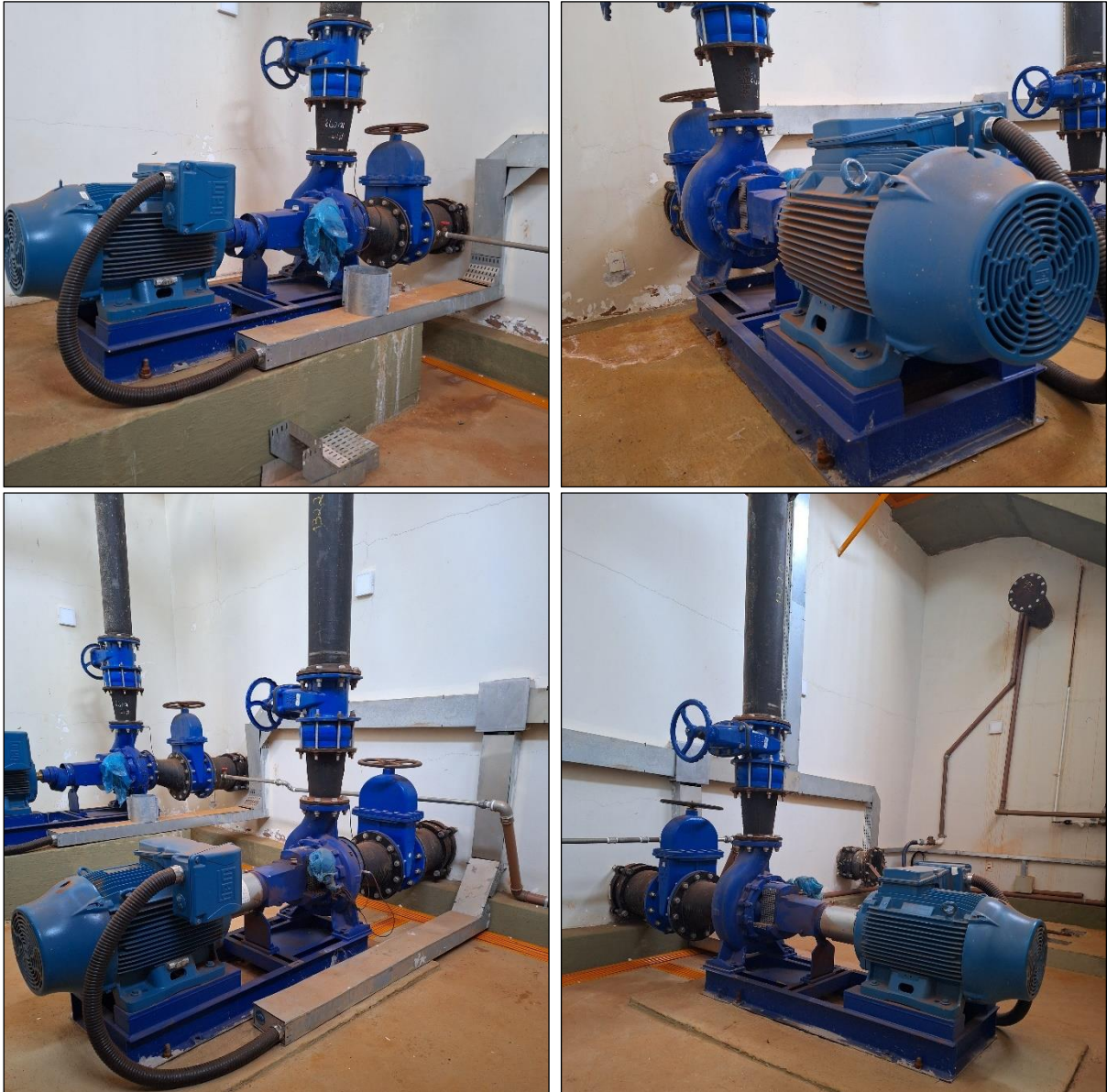
Figura 106: Conjuntos Motobomba Sistema Oeste (C.M.B 1, 2 e 3 respectivamente)
