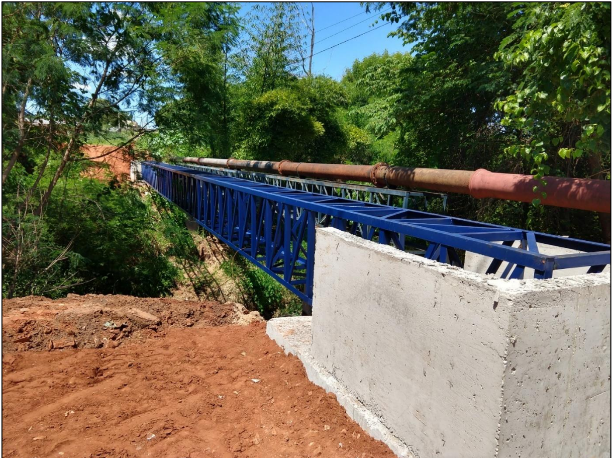
Figura 146 – Travessia aérea (T-4) - ETA-Oeste
