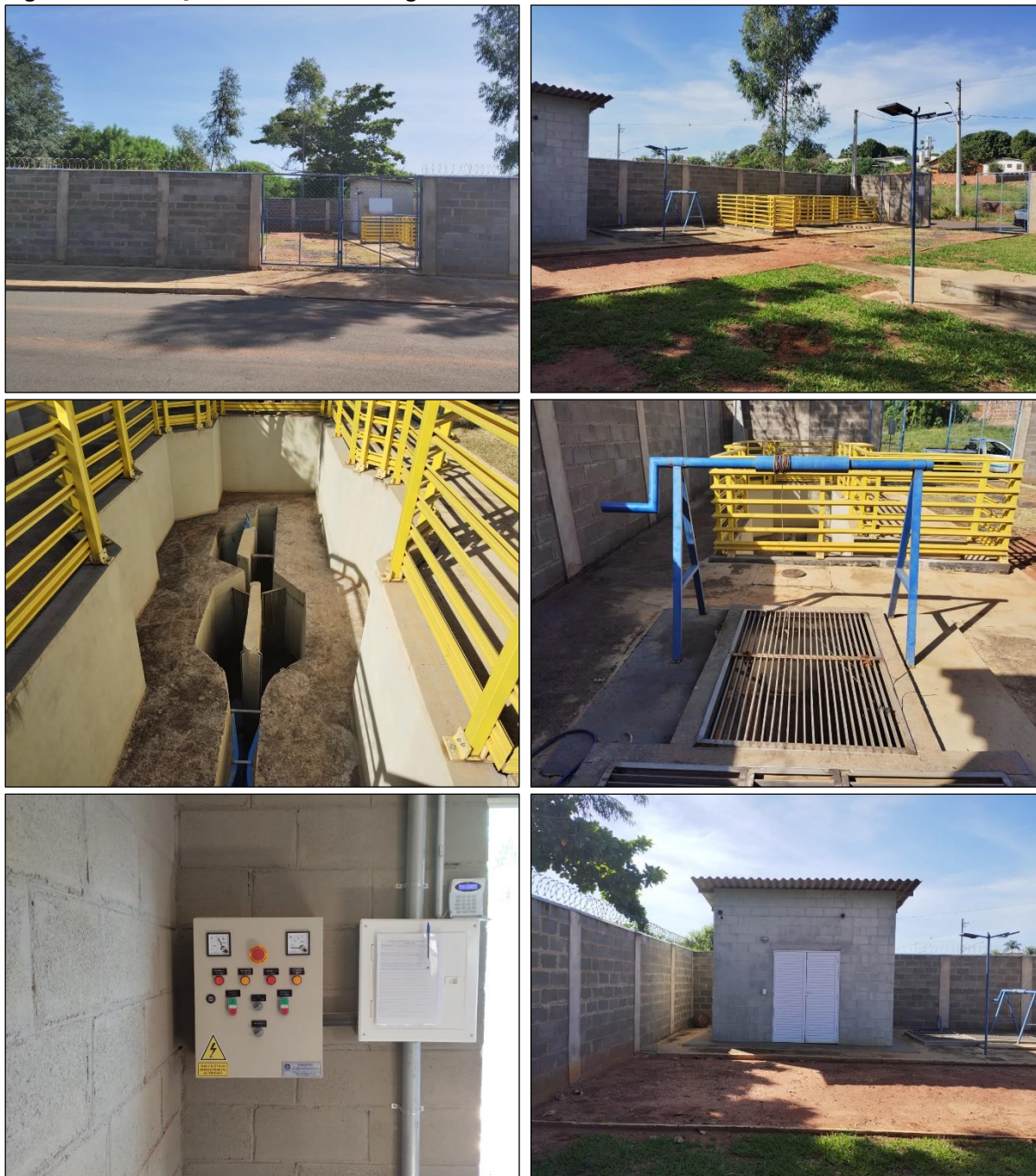
Figura 162: Estação Elevatória de Esgotos São Cosme
