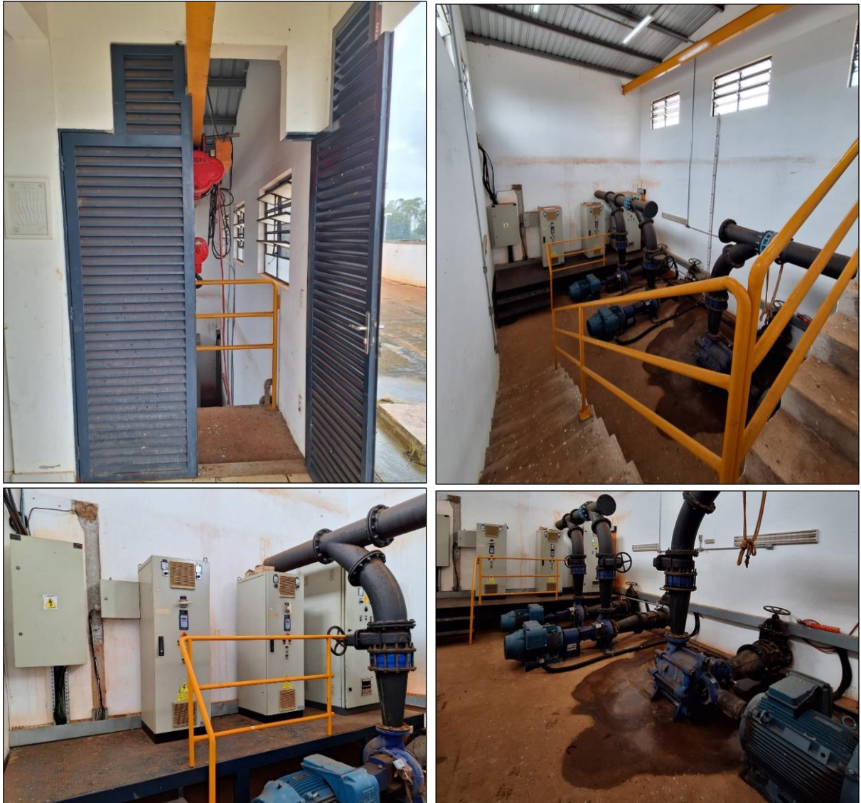
Figura 104: Casa de Bombas Sistema Sudeste
