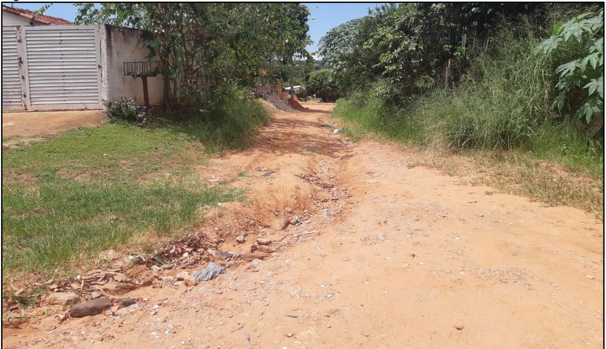
Figura 265: Processo de erosão em rua da Vila Carvalho
