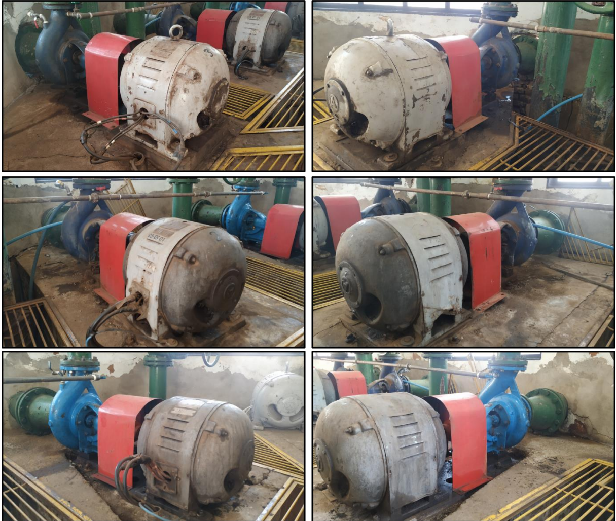
Figura 75: Conjuntos Motobomba ETA (C.M.B 1, 2 e 3 respectivamente)
