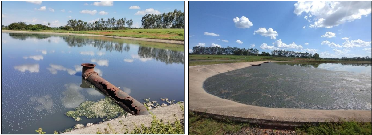
Figura 175: Corrosão dos tubos e presença de material superficial nas Lagoas Facultativas - ETE Votuporanga
