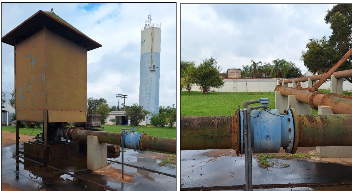
Figura 88: Bomba Poço Profundo e Macromedidor
