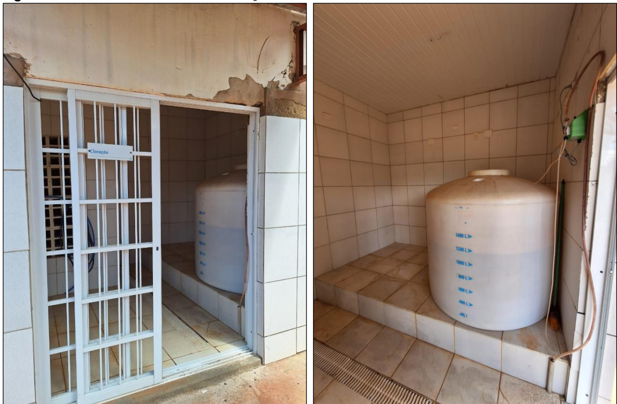
Figura 134 - Sistema de Tratamento Poço Sul
