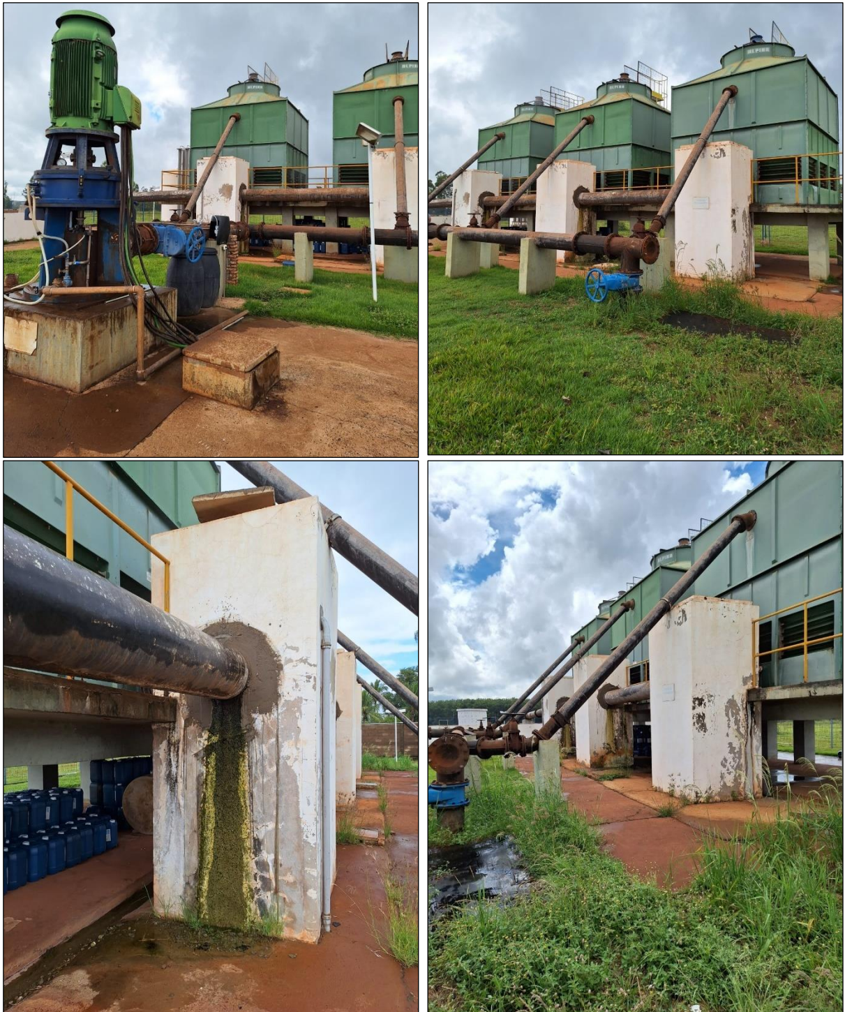
Figura 103: Poço Profundo e Sistemas de Resfriamento de Água Captada
