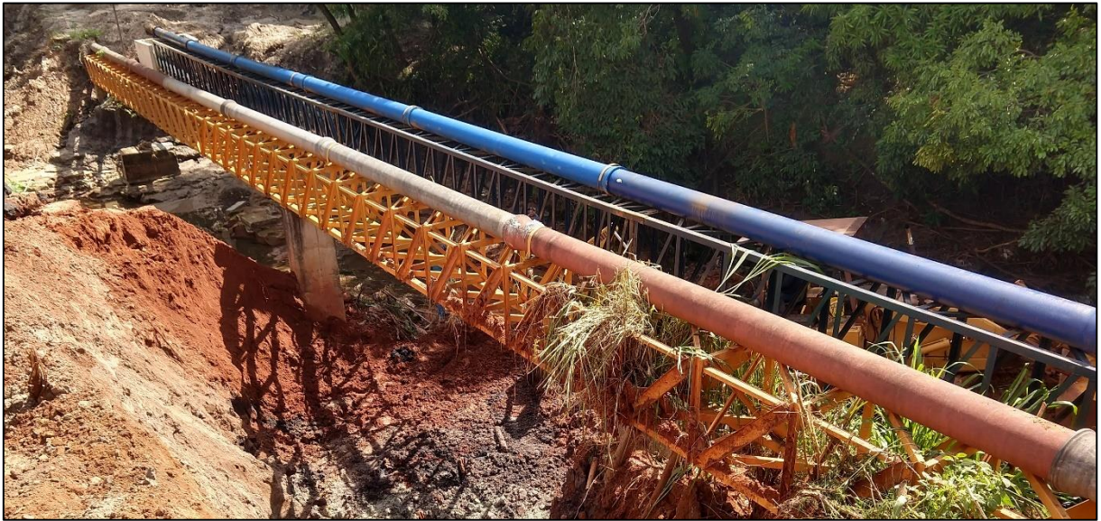
Figura 144 - Travessias Aéreas (T-1 e T-2) – Adutora de Água Bruta
