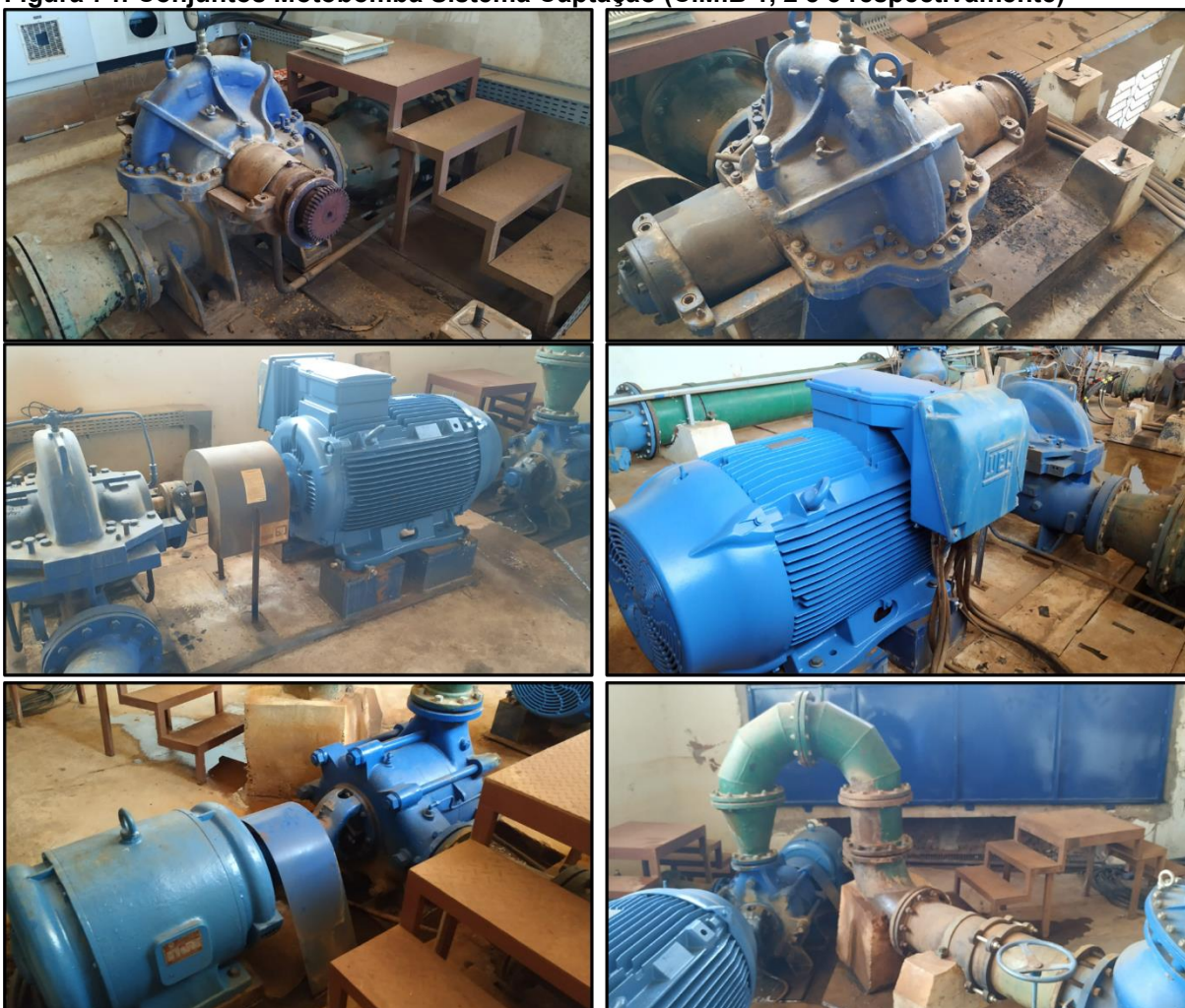
Figura 74: Conjuntos Motobomba Sistema Captação (C.M.B 1, 2 e 3 respectivamente)
