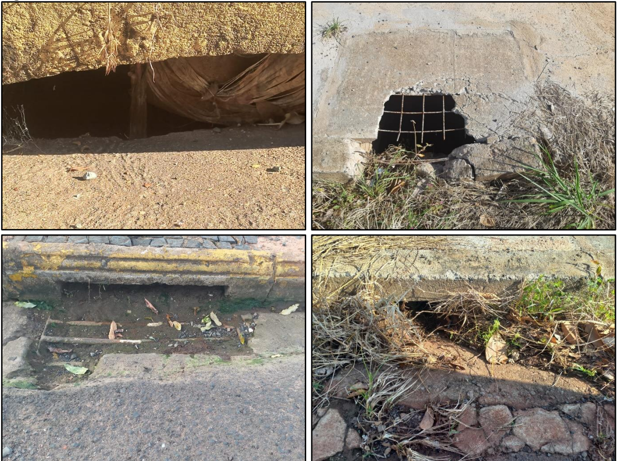
Figura 228: Bocas de lobo sem manutenção
