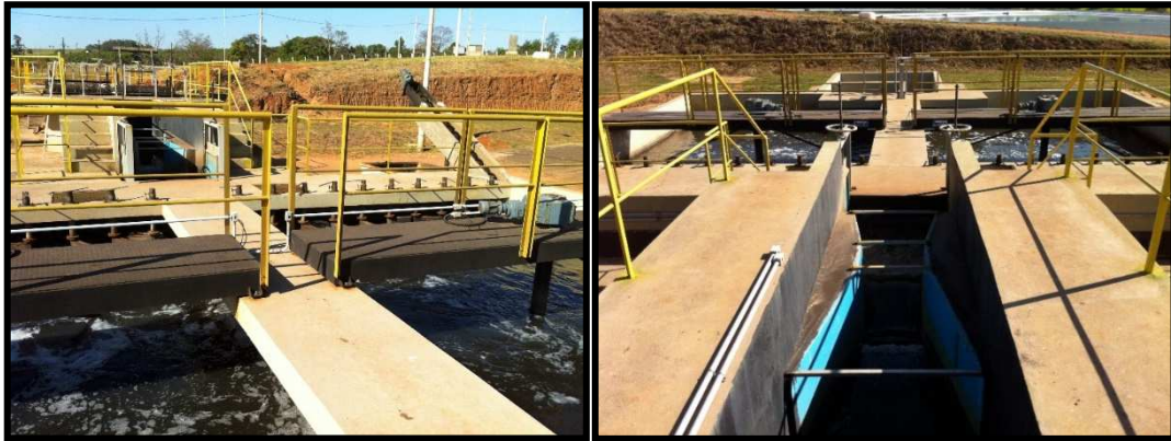
Foto 15: Caixa de Areia - Estação de Tratamento de Esgotos
