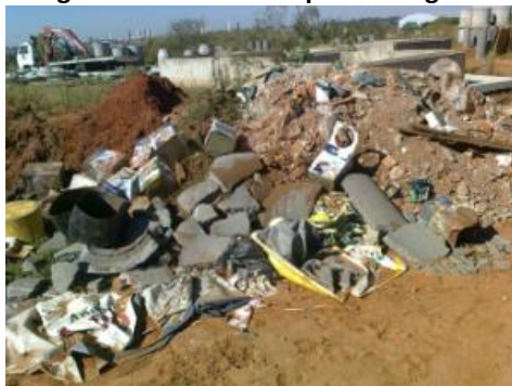
Figura 27: Entulho em ponto irregular.
