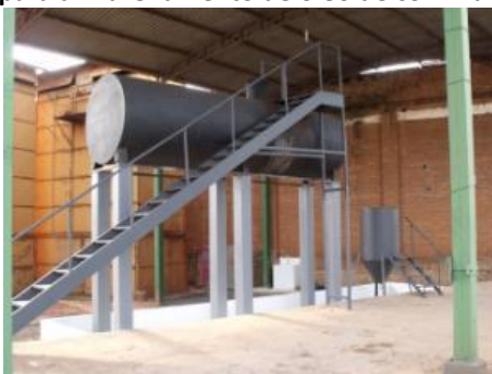
Figura 141: Container para armazenamento de óleo de cozinha usado – ECOTUDO sul.
